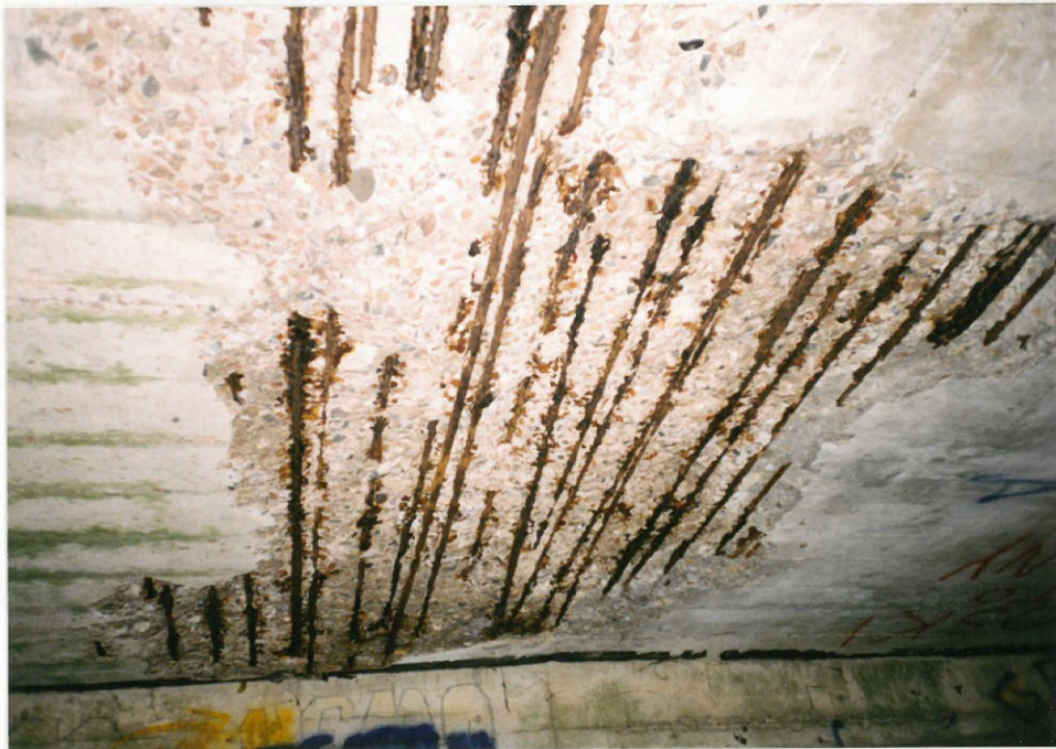
Rys. 11. Odsłonięte zbrojenie w środkowej północnej części płyty nośnej
