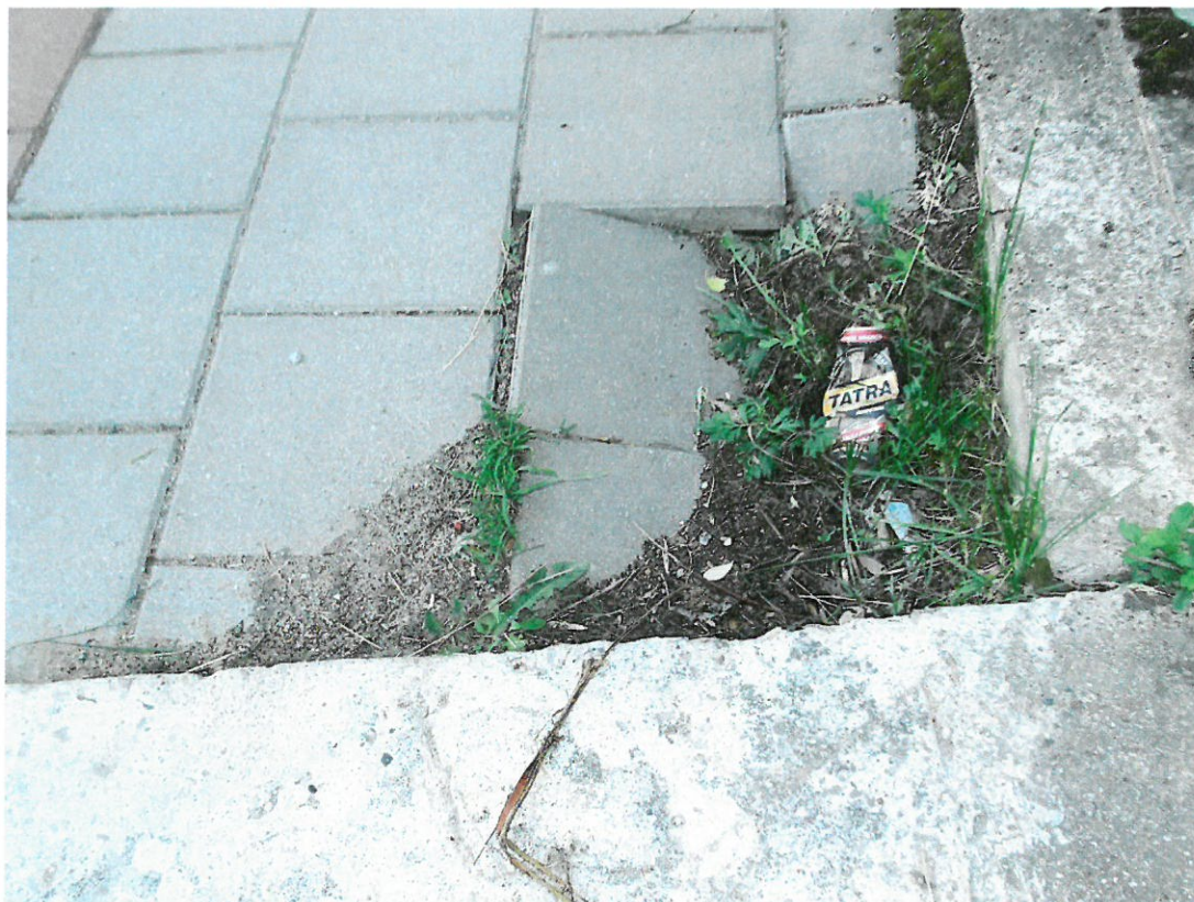
Fot. 8. Zapadnięty chodnik, zanieczyszczenie i roślinność na dojazdach do mostu.
