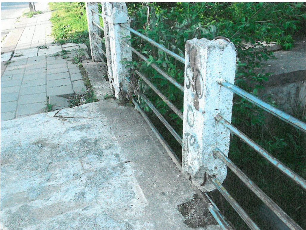
Fot. 7. Ubytek w słupku betonowym poręczy oraz widoczne zbrojenie. Ponadto zanieczyszczenie powłok malarskich
