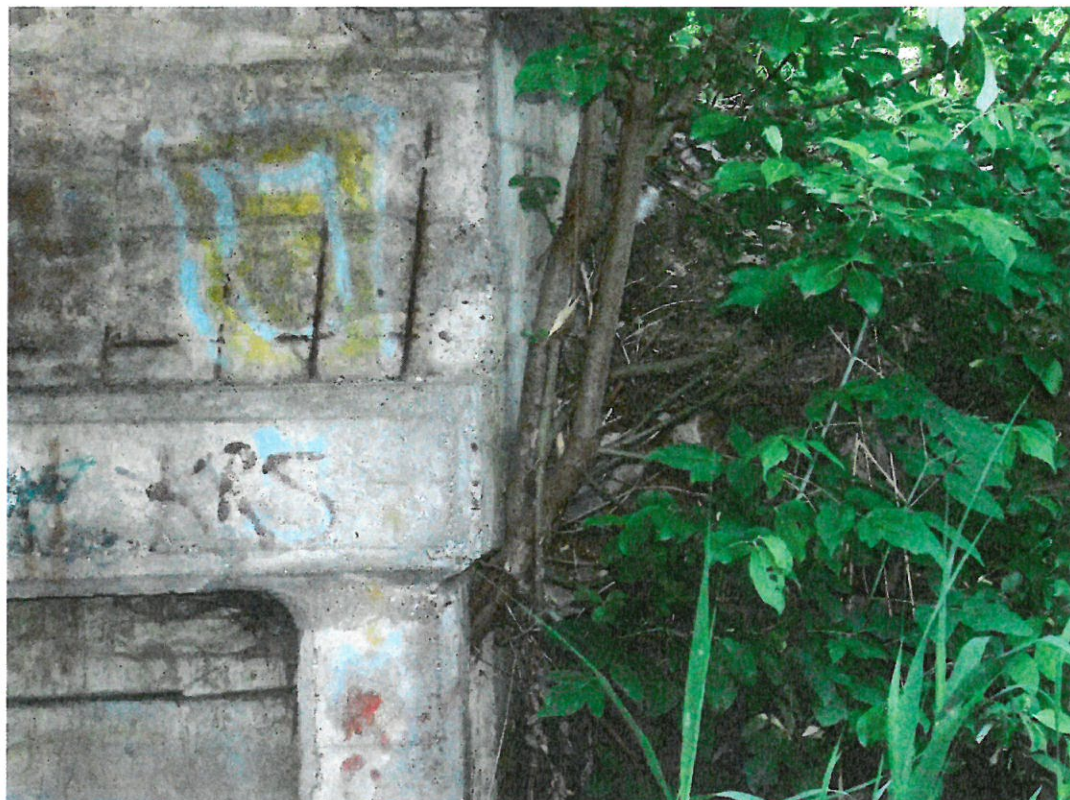
Fot. 5. Bujna roślinność (drzewo) rosnące na przyczółku oraz zanieczyszczenia (graffiti)
