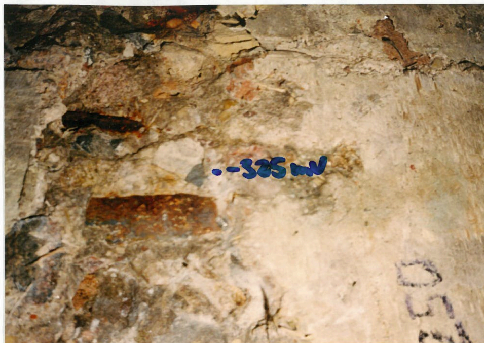
Rys. 6. Odkuwka do zbrojenia w miejscu o potencjale -325mV
