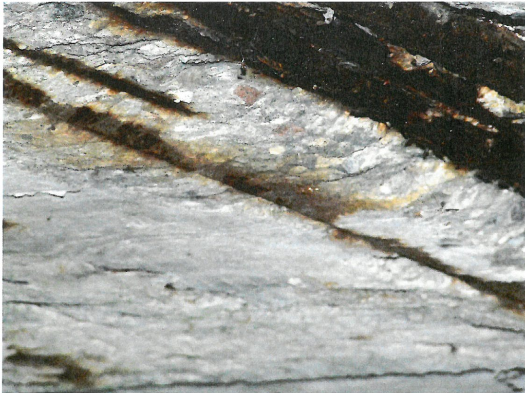
Fot. 4. Brak otuliny zbrojenia oraz widoczna korozja prętów w dźwigarze.
