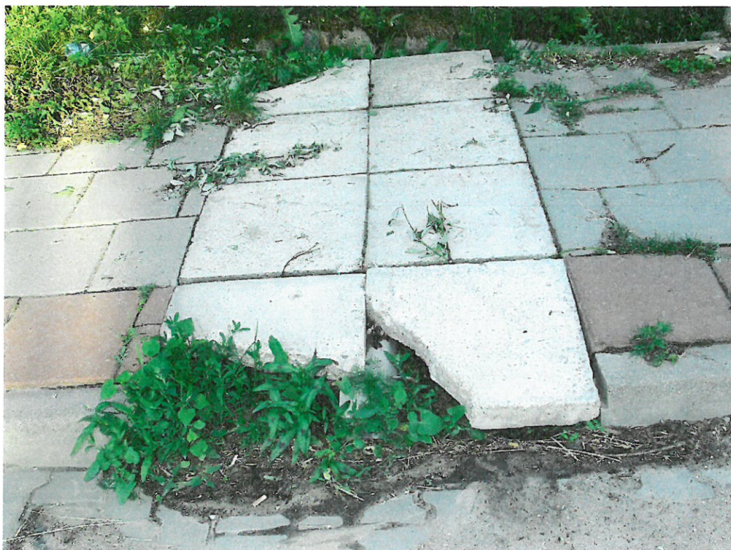
Fot. 9. Zanieczyszczony, niedrożny ciek oraz uszkodzone, połamane płyty chodnikowe przykrywające ciek.
