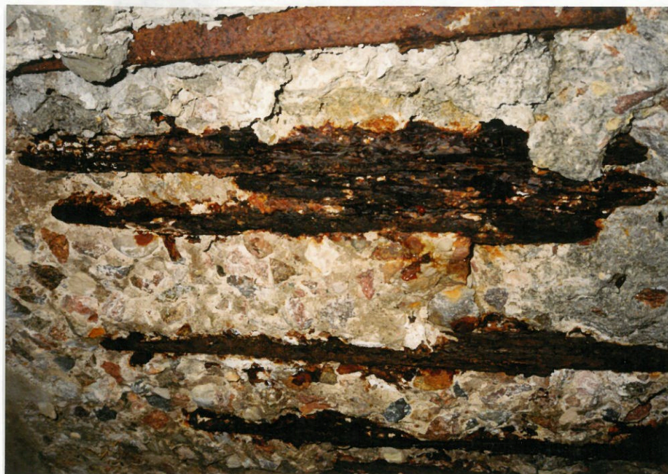
Rys. 5. Odsonięte zbrojenie w środkowej części płyty nośnej
