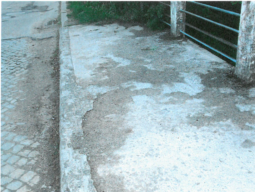
Fot. 6. Ubytki, korozja chodnika betonowego.
