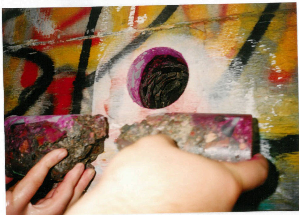
Rys. 3. Pobrana próbka rdzeniowa P1 na tle otworu - nieciągłość próbki to nawiercona kawerna
