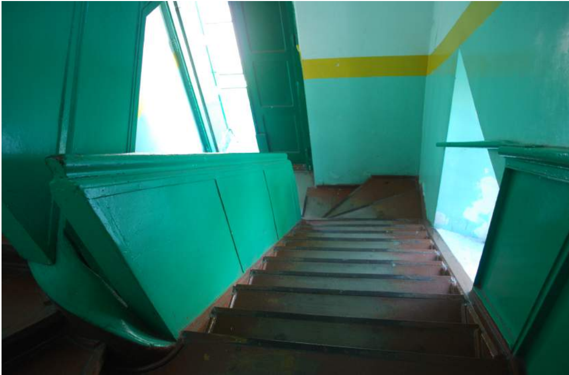
Zdj. nr 4. Klatka schodowa – spocznik pośredni między parterem a piętrem – widok w stronę parteru
