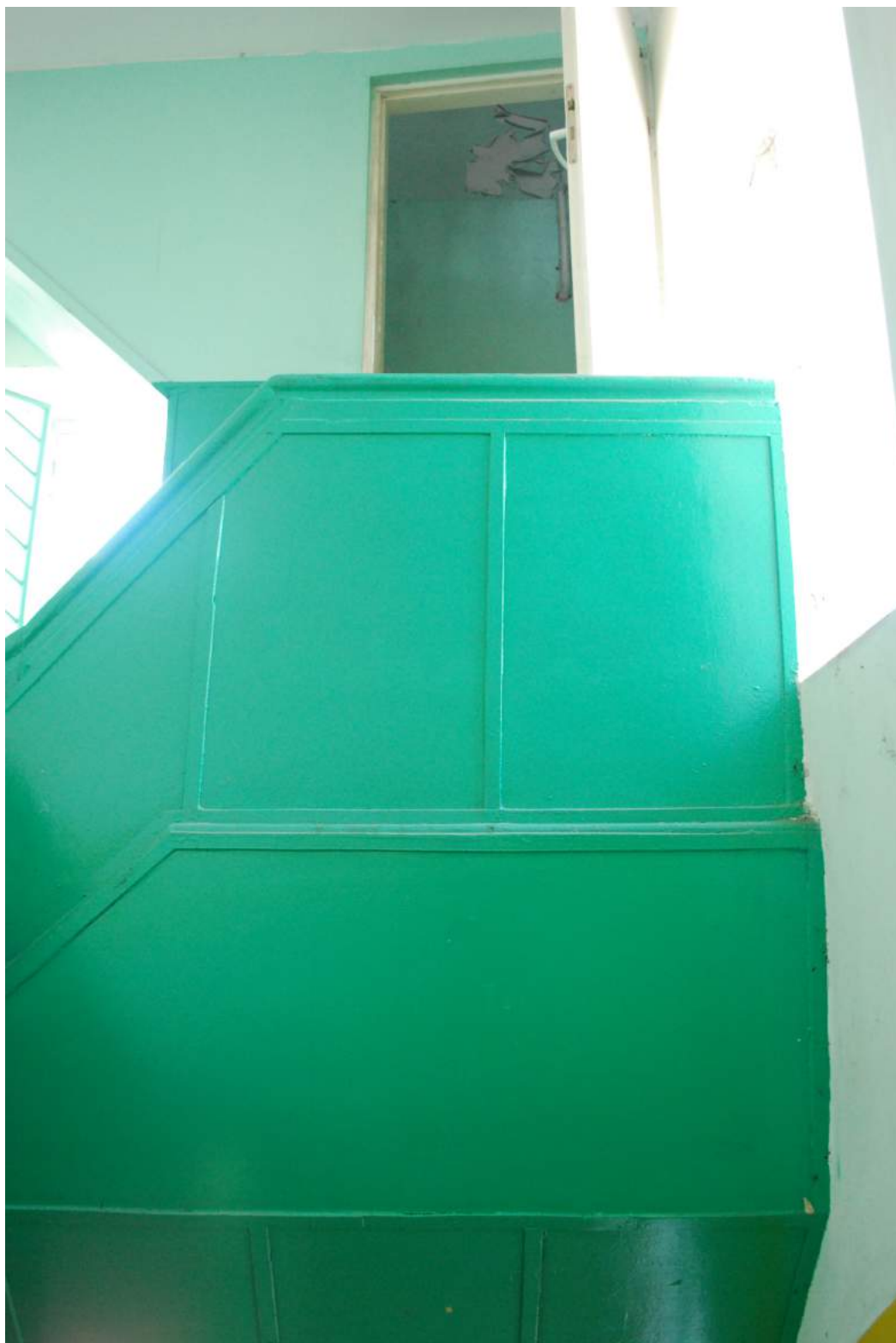
Zdj. nr 6. Klatka schodowa – spocznik pośredni między parterem a piętrem – widok na balustradę biegu prowadzącego na poddasze
